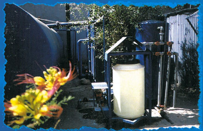
سیستمهای تصفیه نهایی پساب برای آبیاری فضای سبز
